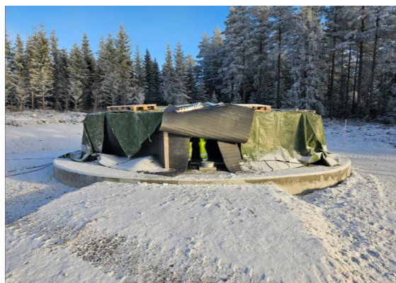
Kanonadens "igloo-lösning". Foto: Vattenfall Site Manager
