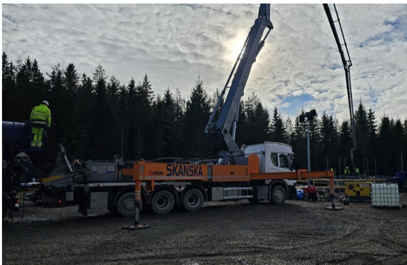
Bilden visar en betongpump som fyller på med ECO-betong vid gjutning av fundament. Foto: Vattenfall
