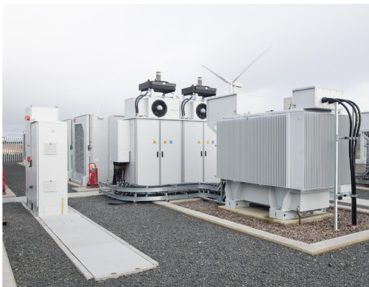
Bilden visar ett batterilager från en av Vattenfalls anläggningar. Foto: Vattenfall
