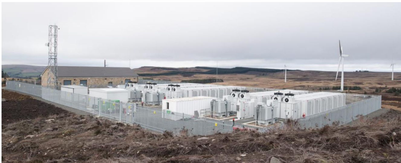
Bilden visar ett batterilager från en av Vattenfalls anläggningar. Foto: Vattenfall
