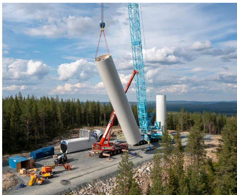
Fotot visar byggnation av ett vindkraftverk vid Vattenfalls vindkraftpark Blakliden-Fäbodberget. Foto: Vattenfall
