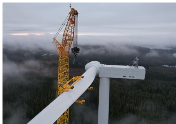
Byggnation av ett vindkraftblad på ett vindkraftverk vid Vattenfalls vindkraftpark Grönhult. Foto: Vattenfall
