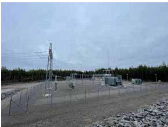
Figur 9. Transformatorstation i vindkraftpark Hultema.
