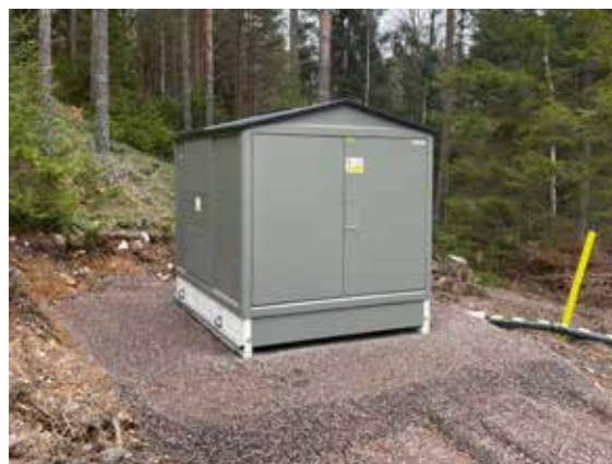
Figur 10. Kopplingskiosk i det markförlagda kabelnätet.
